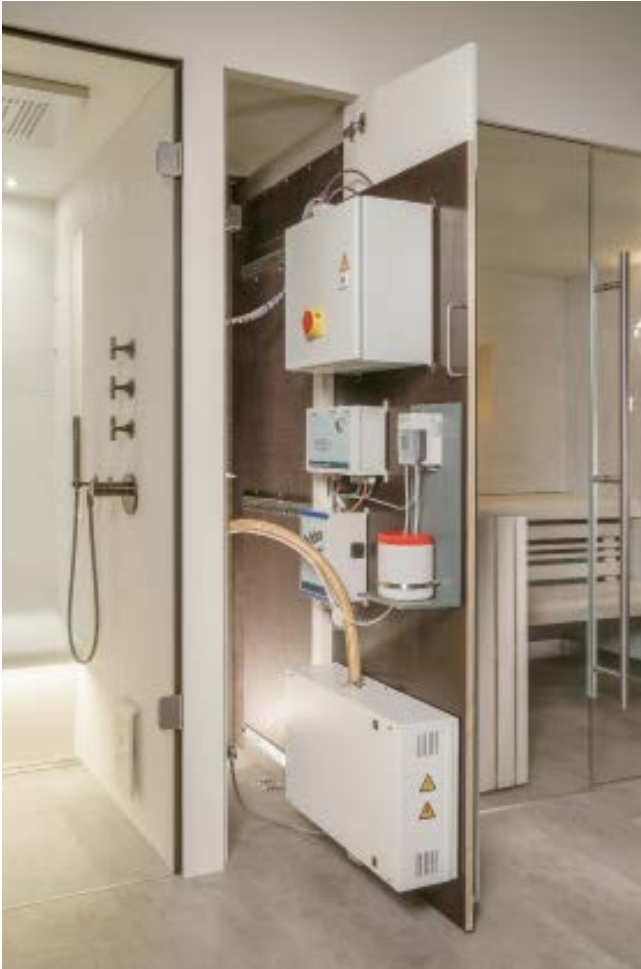
WDT-Dampftechnik ist auf einer Platte installiert und herausziehbar.
