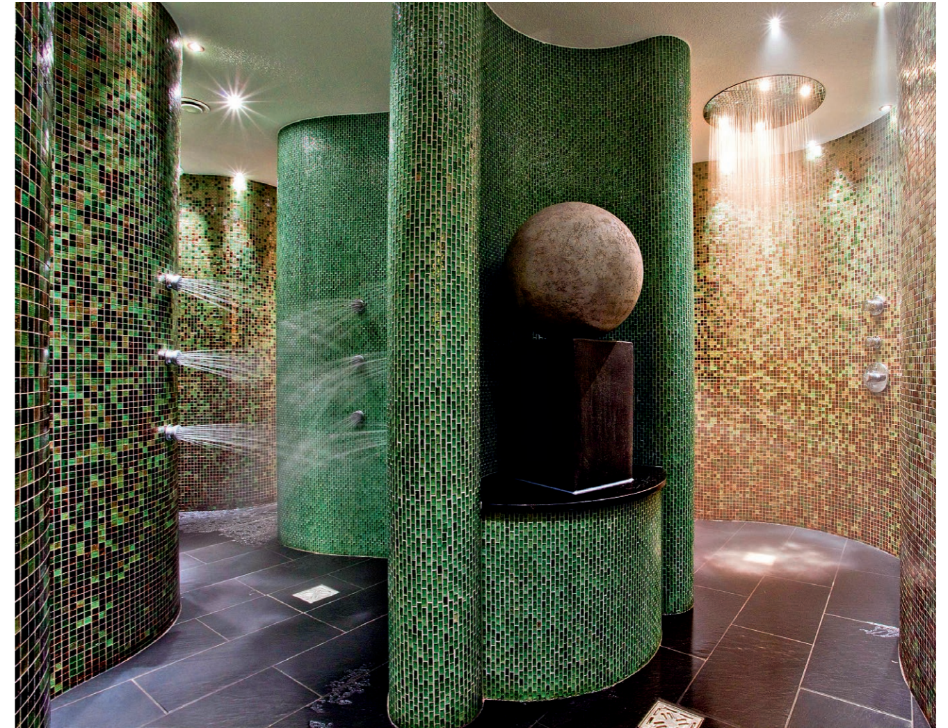
Eine von KLAFS realisierte Erlebnisduschenanlage im Wellnessbereich des ESPA-Hotels in Riga. Die Gäste durchlaufen verschiedene Stationen mit ganz unterschiedlichen Duschprogrammen. ( www.klafs.de )
