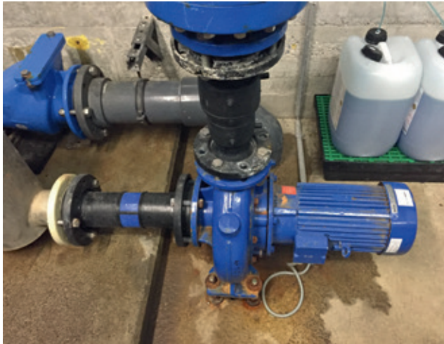
← Aufbereitung Springbrunnenanlage, Foto: Lutz-Jesco GmbH
